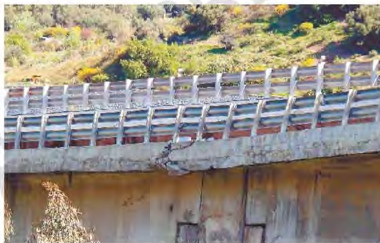
Il viadotto Himera, con gli evidenti segni di cedimento strutturale
